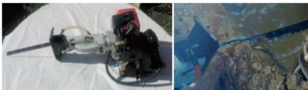
Figura 7 - Taglio di una tubazione mediante seghetto alternativo a motore (a scoppio) a bassa velocità di rotazione.
